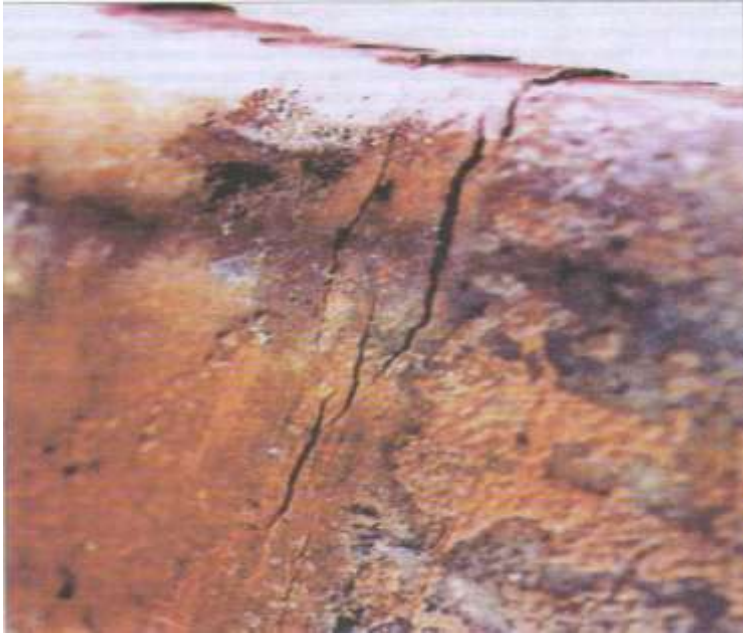
5-нй surat. Sarsgyn korroziýasynyň netijesinde ýüze çykýan jaýrylma.
