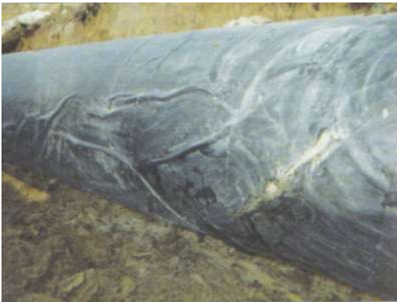
3-njy surat. Polimer lentasy arkaly edilen korroziýadan gorag gatlagynyň zaýalanýşy.
